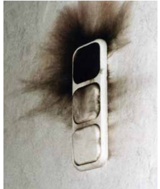
Schwelbrand in einer Unterputzschalterdose
